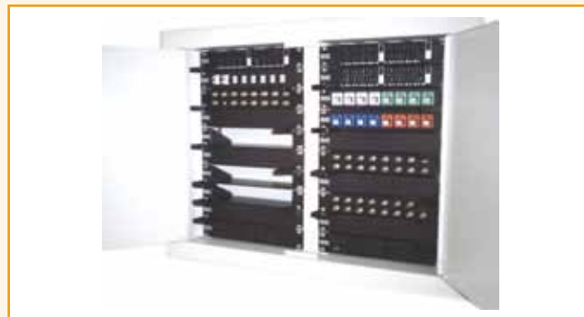
Figura 2 – Exemplo de um centro de conectividade.
